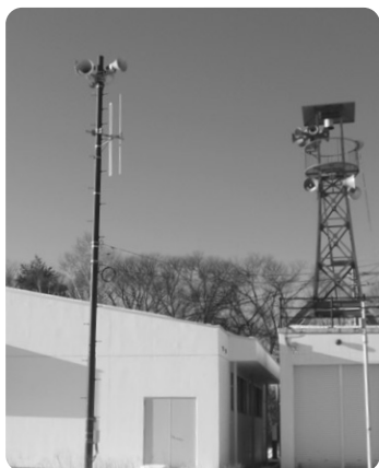
防災無線用パンザマスト
