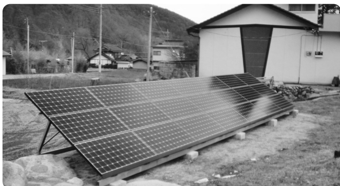
設置されたソーラーパネル
