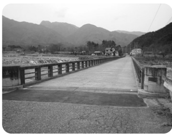
早期架け替えが望まれる駒城橋
