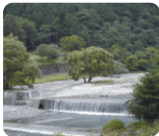
土砂が堆積している大武川
