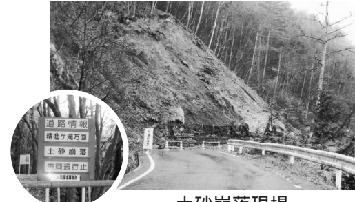
土砂崩落現場
