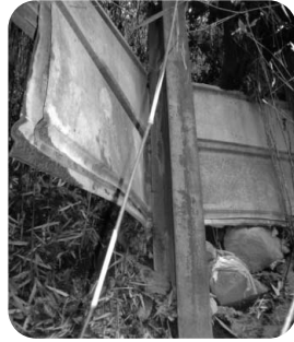
危ない、崩落しそう
