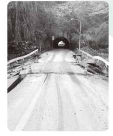
能登半島地震の被災地〈災害派遣の市職員撮影〉
