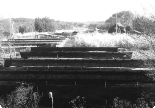
地上設置型太陽光発電システム
