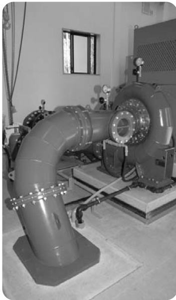
クリーンでんでん (小水力発電・村山六ヶ村堰)
